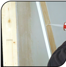
Acabado de Puerta
