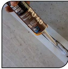
Junta de Dilatación
